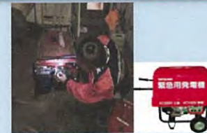
・自家発電機の導入
