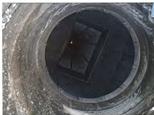
写真2 焼損した免震継手内部の状況
