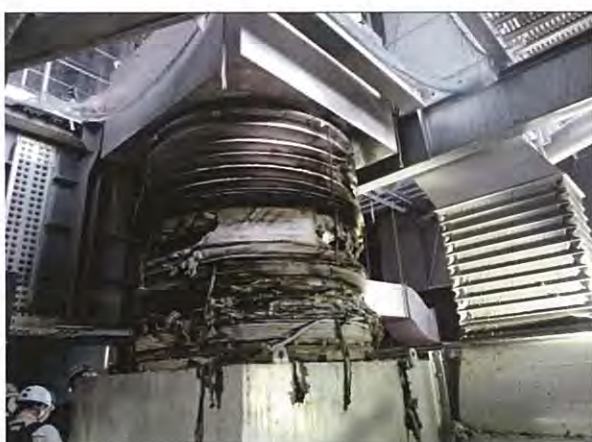
写真1 焼損した煙道用免震継手
