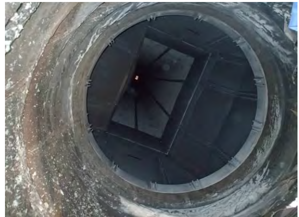
写真2 焼損した免震継手内部の状況
