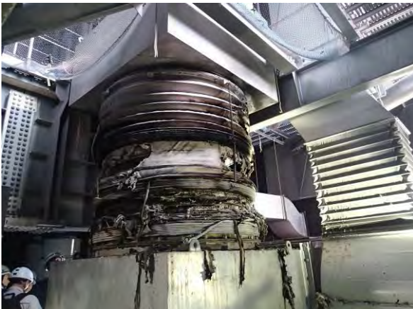
写真1 焼損した煙道用免震継手
