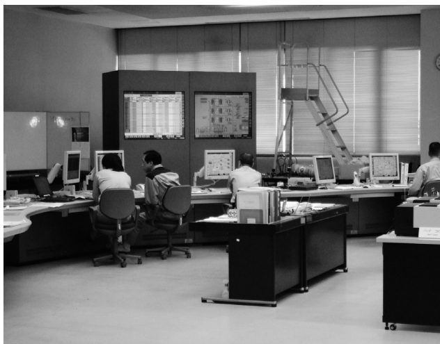
監視センター
