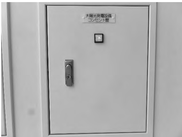
太陽電池発電設備専用コンセント盤
