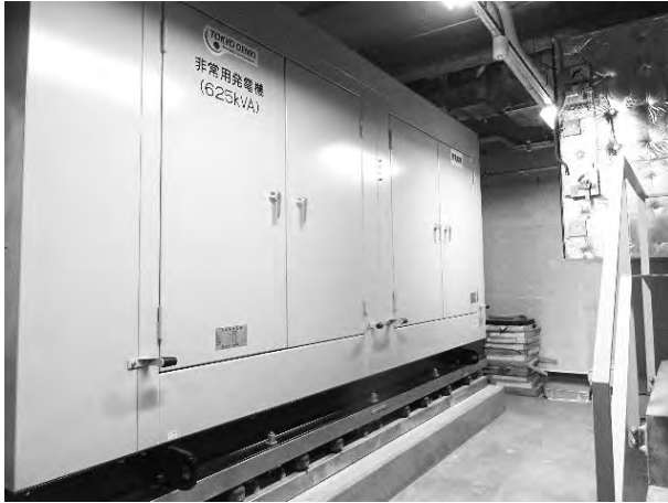
自家発（出力625kVA×1基）
