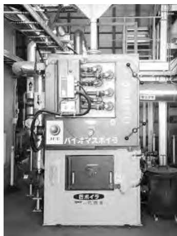
バイオマスボイラ
