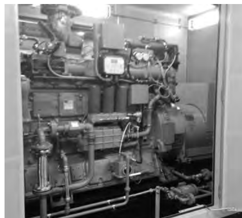
ガスエンジン発電装置
