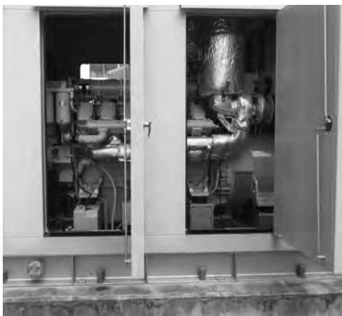
株式会社親和銀行本店設置の自家発電機 (エンジン部分)
